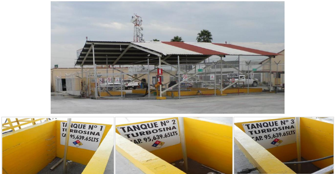
Figura I.5.1.3 Área de Almacenamiento subterráneo de Turbosina
