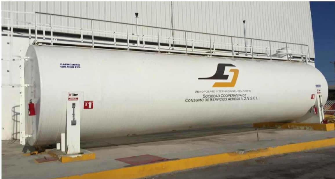
Figura I.5.1.4 Tanque superficial de Almacenamiento de Turbosina
